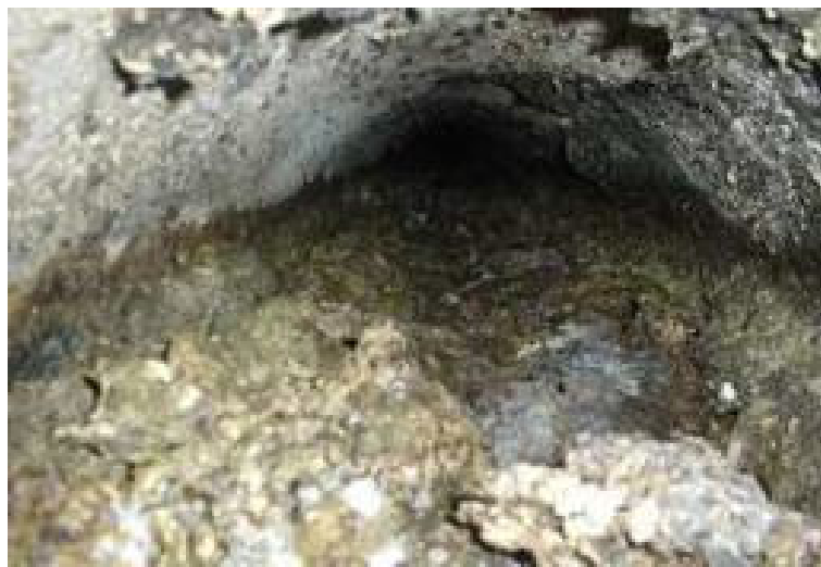
配管のつまり (油脂類)
