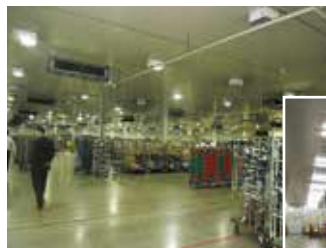
照明機器更新前
