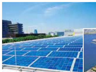
太陽光発電システム
