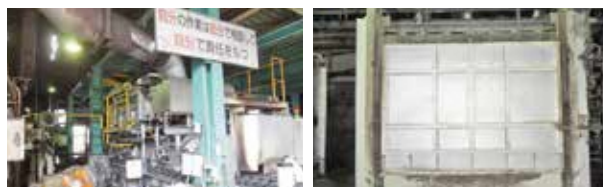
省エネ型・高効率熱処理炉の導入 炉扉の断熱・拡大化による熱放散対策
