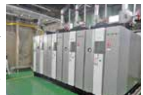
ボイラー更新後
