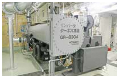
インバーターターボ冷凍機
