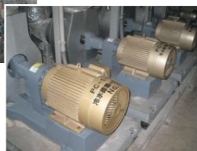
冷水循環ポンプ
