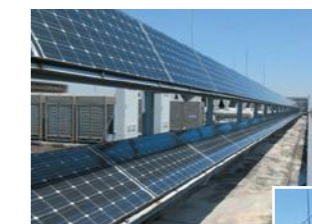
太陽光発電設備
