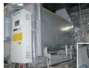
吸収式冷凍機
