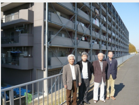
平成18年に耐震改修工事を実施した豊栄綱島マンションと管理組合のみなさん
