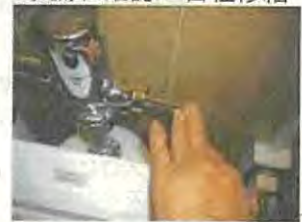
水漏れ確認・自社修繕
