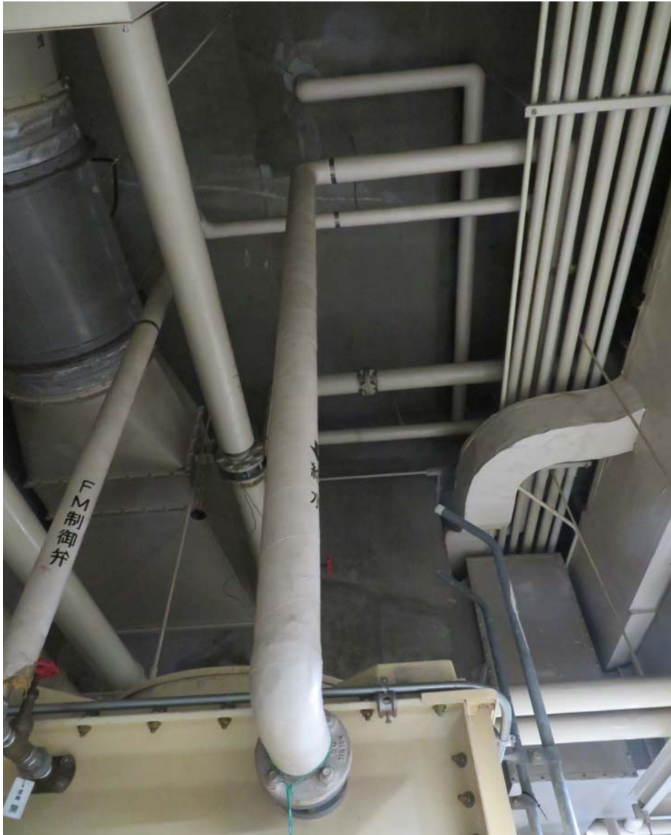
地下機械室内 接続配管類
