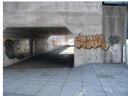
<落書きがされた国際橋下遊歩道>
