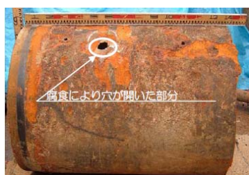
腐食性土壌が原因で漏水した配水管
