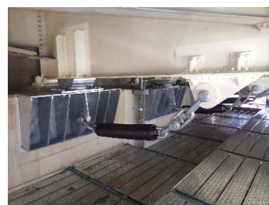
橋梁の耐震化(落橋防止装置の様子)
