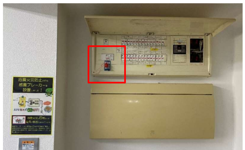
自治会館の配電盤に設置する感震ブレーカー
