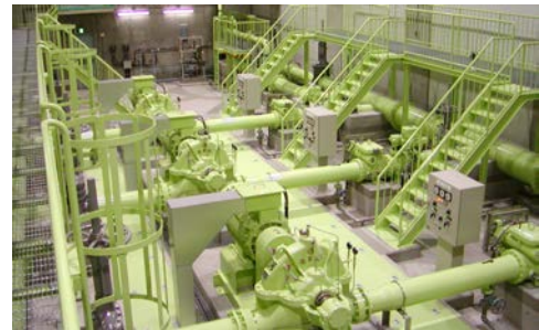
配水ポンプ (VVVF制御方式)
