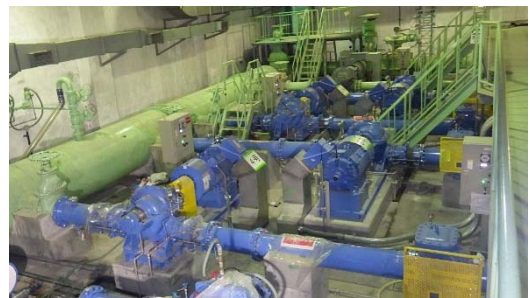
配水ポンプ(VVVF制御方式)
