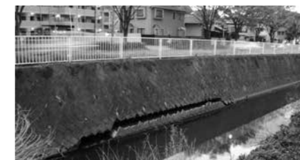
河川護岸の崩壊
