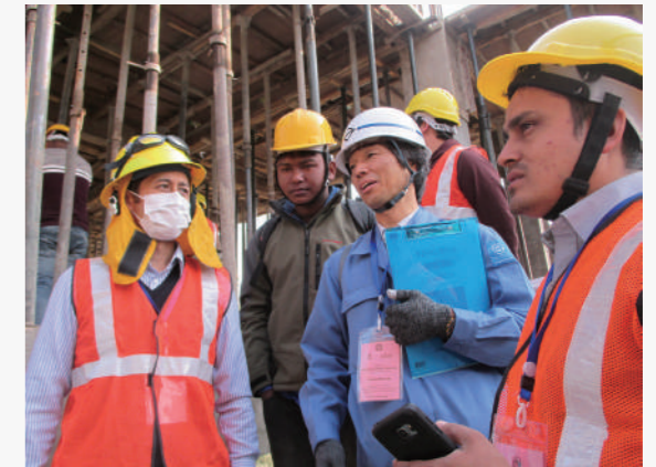
ネパール・カトマンズ市震災復興への横浜市による技術協力
