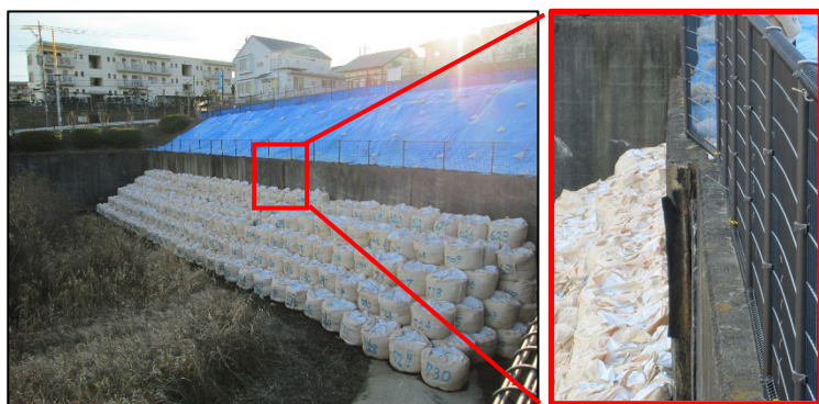
調整池の擁壁傾き
