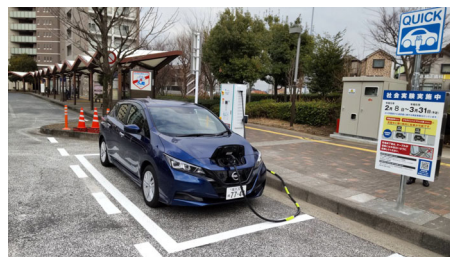
公道充電ステーション (センター南駅前ロータリー)
