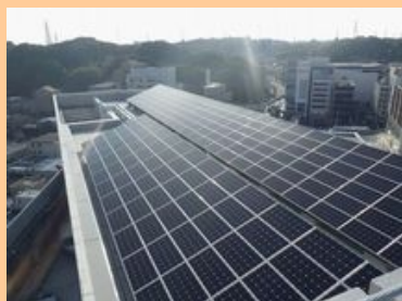
「戸塚区庁舎・太陽光発電設備」
