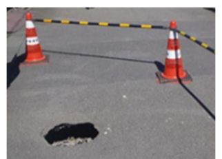
取付管破損による道路陥没
