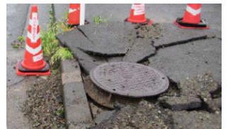
マンホール浮上被害状況
