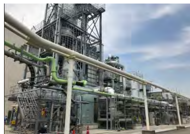
下水汚泥燃料化設備
