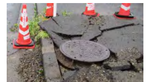
マンホール浮上被害状況
