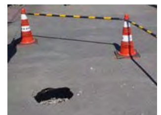
取付管破損による道路陥没
