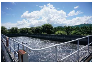
バタミンド工業団地内汚水処理施設
