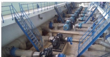
今回導入した省エネ型送水ポンプ
