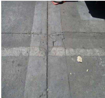
整備工場内 床割れ
