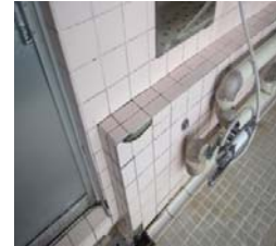
浴室壁・側溝タイル剥がれ
