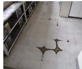
事務室前廊下仕上不良
