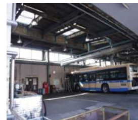
車庫内鉄骨錆状況
