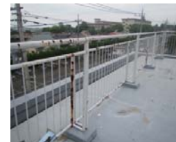
屋上手摺腐食・防水層不具合
