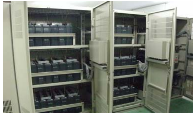
鉛蓄電池設置状況
