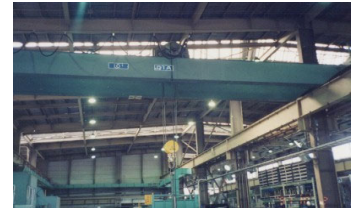
(10tホイス付天井クレーン)
