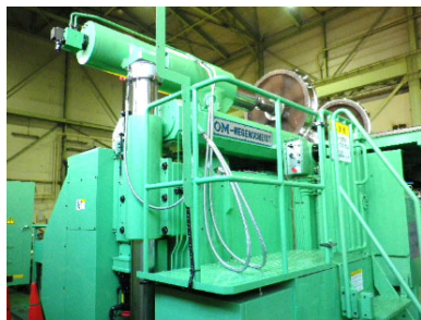
新羽車両基地 車輪転削盤
