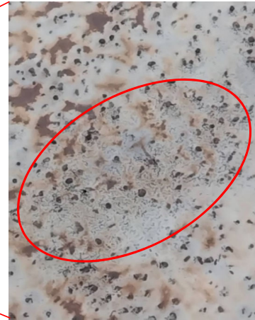
絶縁材ひび割れ
