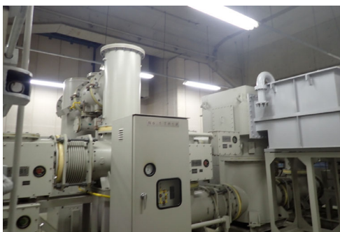
66kV 特別高圧受電設備
