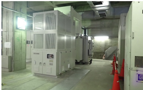
←整流器 (写真は参考として三ツ沢変電所のもの)
