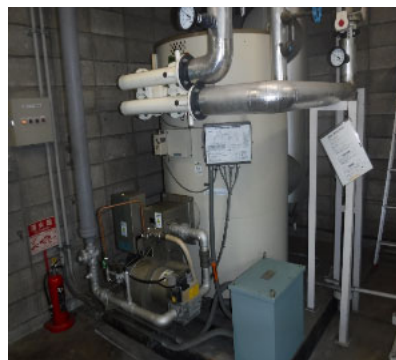
【既設給湯ボイラー】
