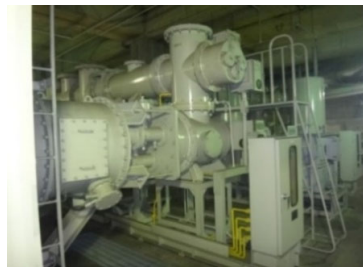
66kV 特別高圧受電設備
