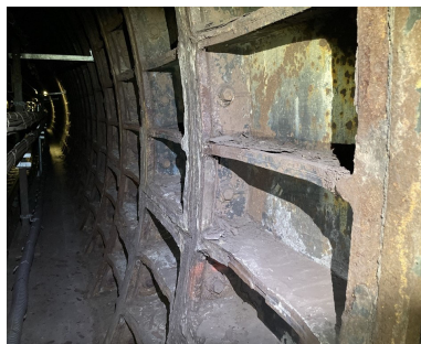
▲ダクタイルセグメントの劣化状況
