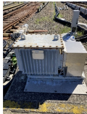
帰線自動開閉器
