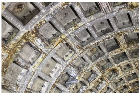
▲RCセグメントの劣化状況
