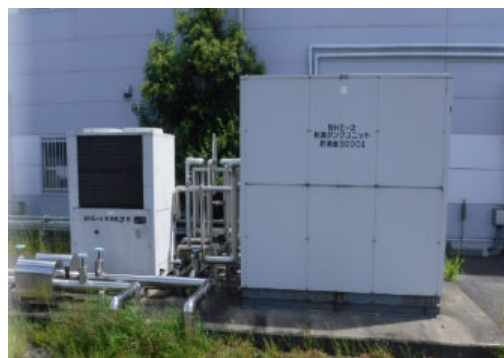
【川和車両基地総合事務所棟給湯器】
