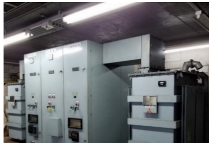
弘明寺駅電気室のPCB含有変圧器
