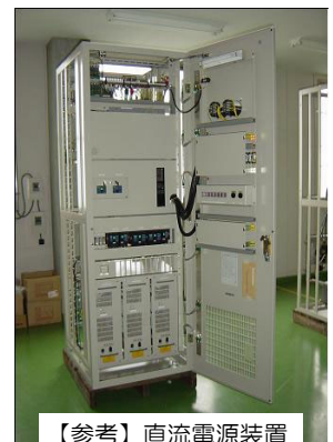
【参考】直流電源装置
