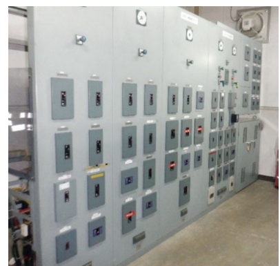
(印加部が露出している為、保守作業時に感電の恐れがある)
