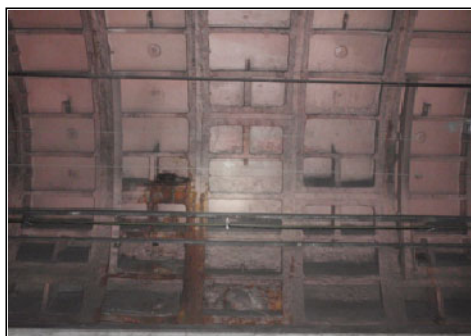
▲ダクタイルセグメントの劣化状況
