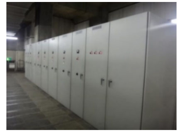
直流き電設備
