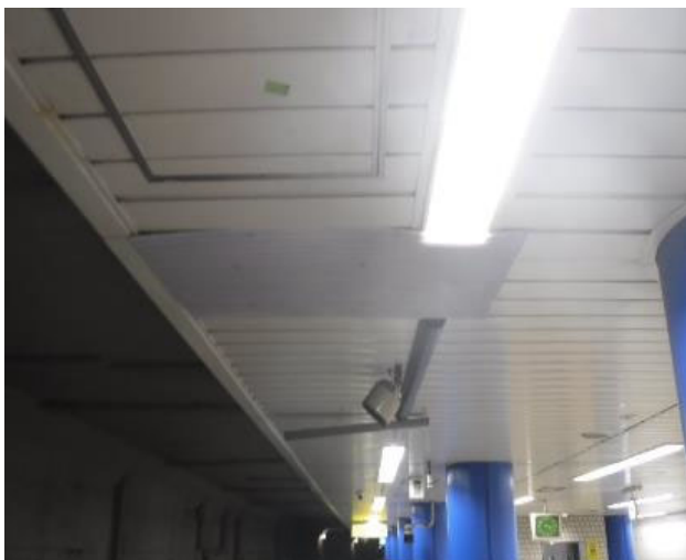
ホーム階天井からの漏水
