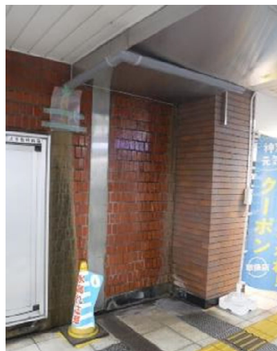
出入口改札間 通路天井からの漏水
