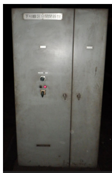
開閉器盤外観
