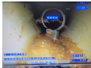
モルタルの不法投棄
