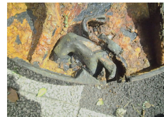
マンホールの破損
