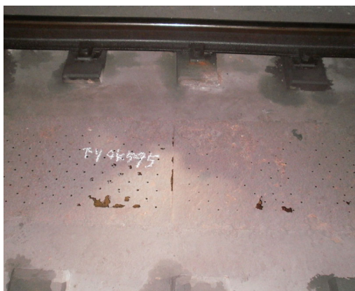
排水溝蓋(アンチスリップ鋼板)
