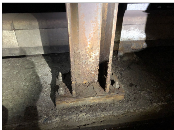
▲高島町駅ホーム下支柱(H鋼)腐食状況
