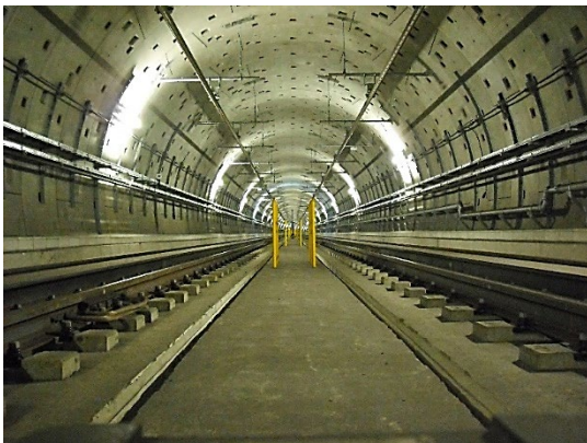
<トンネル照明>
