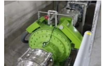
小水力発電設備
