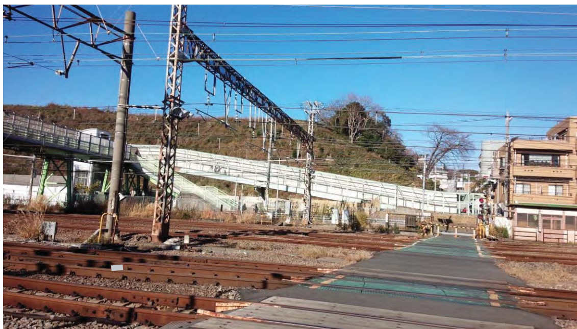
写真2 老朽化したスロープ周辺
