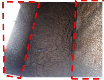
写真2 最終沈殿池流入水路 躯体劣化(骨材露出)
