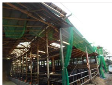
畜舎の屋根の破損
