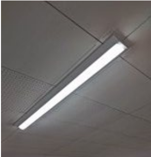
【普通教室照明（整備例）】
