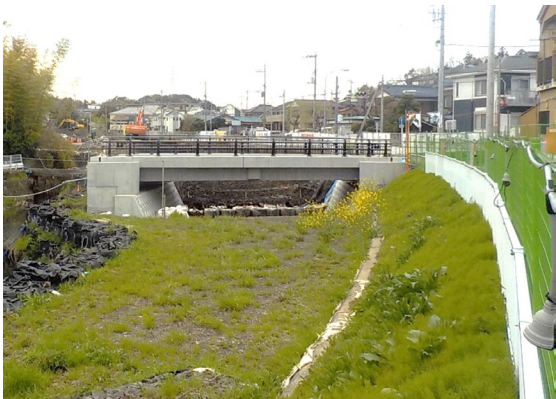
【帷子川流域における河道掘削・護岸整備・橋梁架替え（整備例）】
