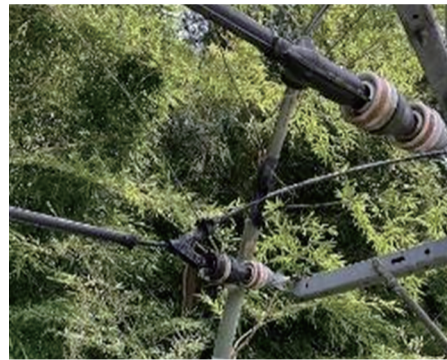
電線に樹木が接触する様子
