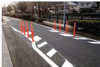
道路空間の安全対策の例 (狭さくの設置)
