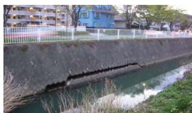
河川護岸の崩壊
