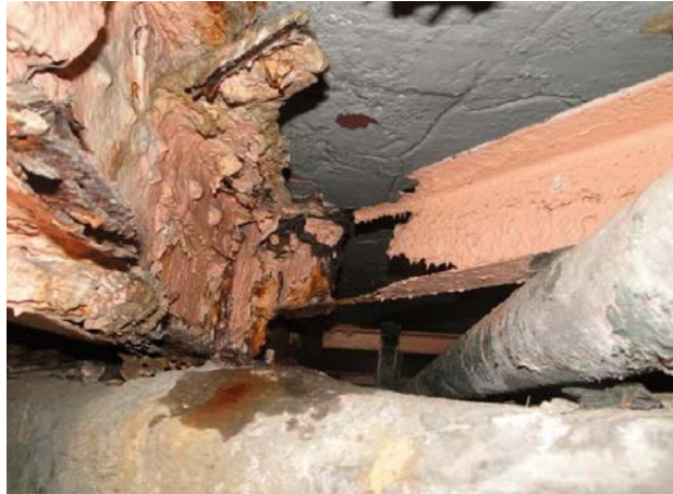
腐食した橋桁 (浅山橋／西区)
