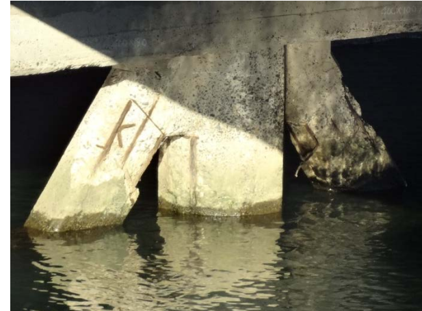
鉄筋が露出した橋脚 (烏帽子田橋／中区)
