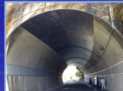
迎陽隧道（港南区）／補修
