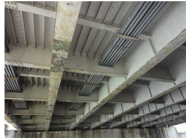
劣化した塗装面 (弁天橋／中区)
