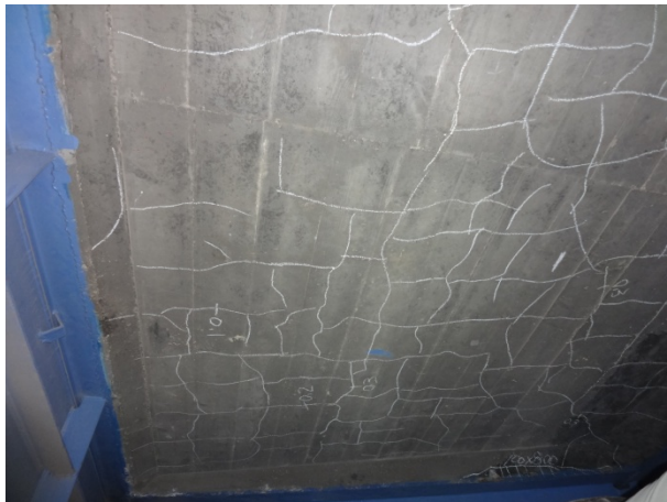
ひび割れした床版 (鶴見大橋／鶴見区)
