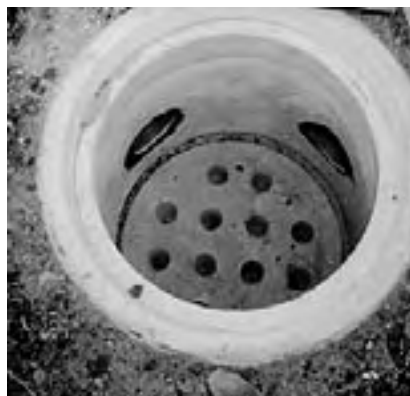
■雨水浸透マス
