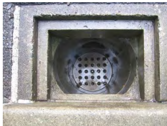
雨水浸透ます
