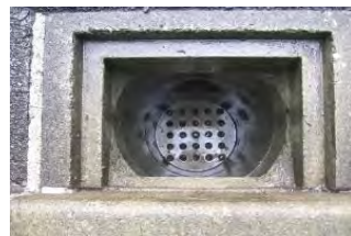
雨水浸透ます
