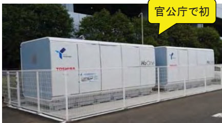
官公庁で初 自立型水素燃料電池システム @横浜港流通センター
