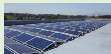
屋上を利用した太陽光発電設備の設置
