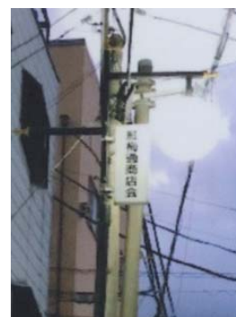
LED 照明に交換した街路灯 (紅梅通り商店会 (西区))
