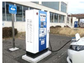
急速充電設備（旭区）
