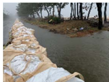
大型の土嚢を積んで背後地への浸水を阻止 (金沢区福浦・幸浦地区)
