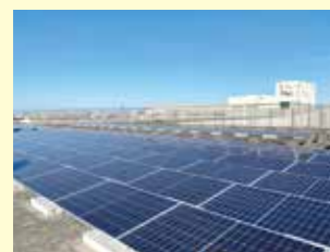
学校に設置した太陽光発電設備
