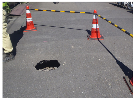
取付管破損による道路陥没
