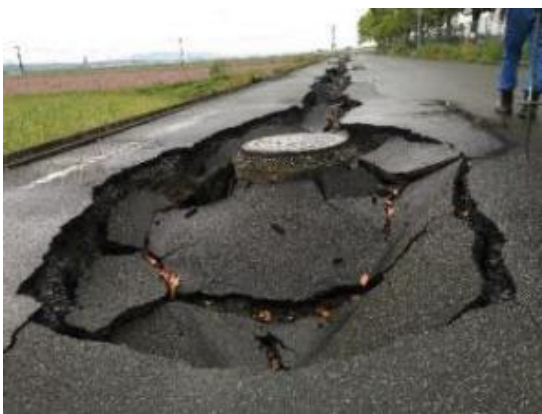
2016（平成28）年 熊本地震被害状況（下水道管）
