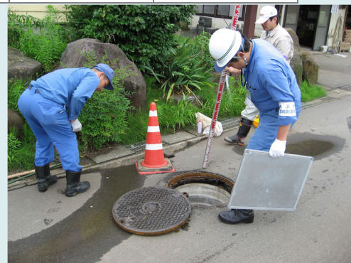
新潟県中越沖地震 調査時の様子
