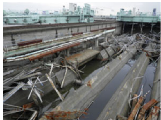
2011（平成23）年 東日本大震災被害状況（施設）
