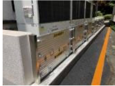
機械設備の耐水化（止水板）
