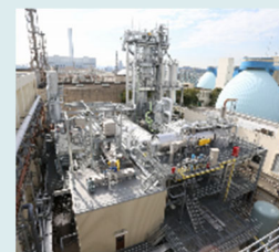
下水汚泥燃料化施設
