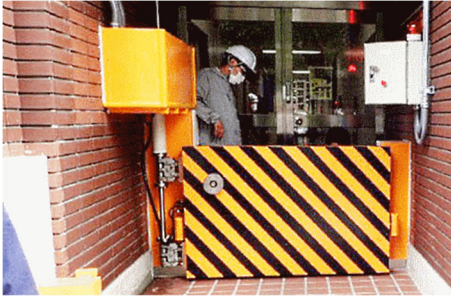
建物の耐水化（防水扉）
