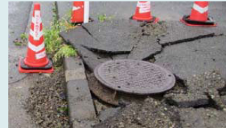
マンホール浮上被害状況
