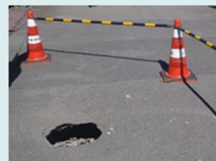
取付管破損による道路陥没
