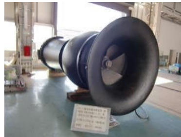
再整備後のポンプ設備
