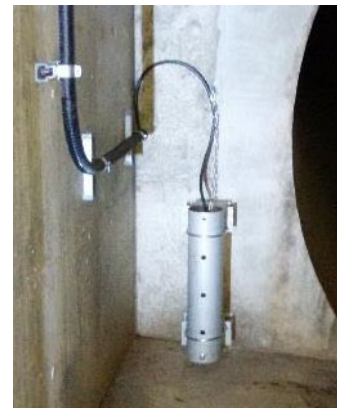
水位計設置状況
