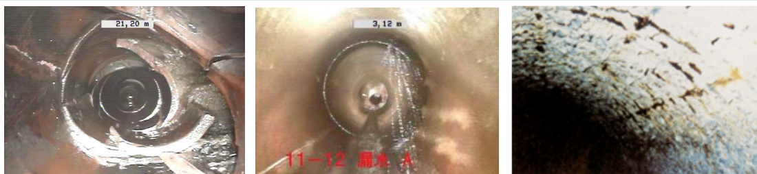
状態監視で見えてきた異常箇所的事例 本管の破損（左） 浸入水（中） 鉄筋の露出（右）
