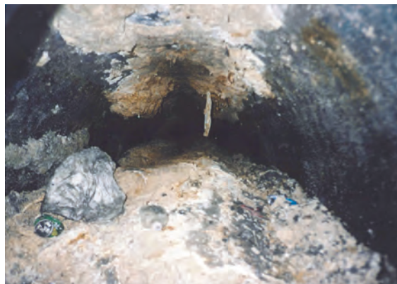
油で詰まっている下水管
