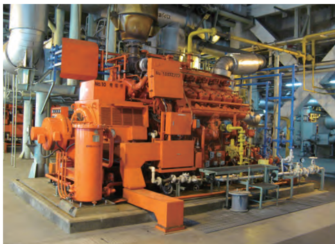
消化ガス発電機
