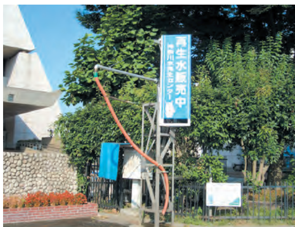
再生水供給装置
