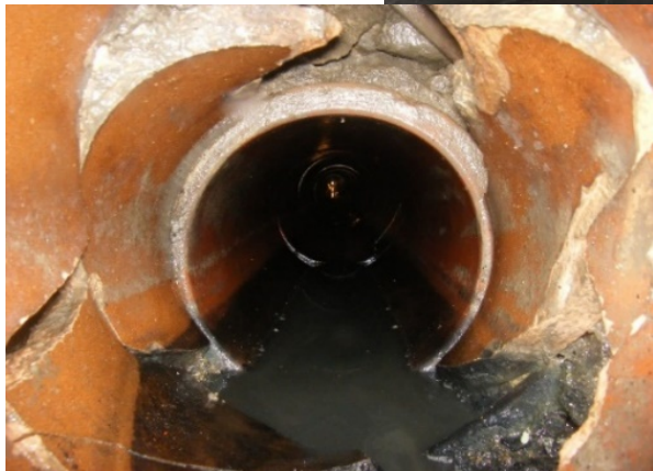
下水道管が破損した様子
