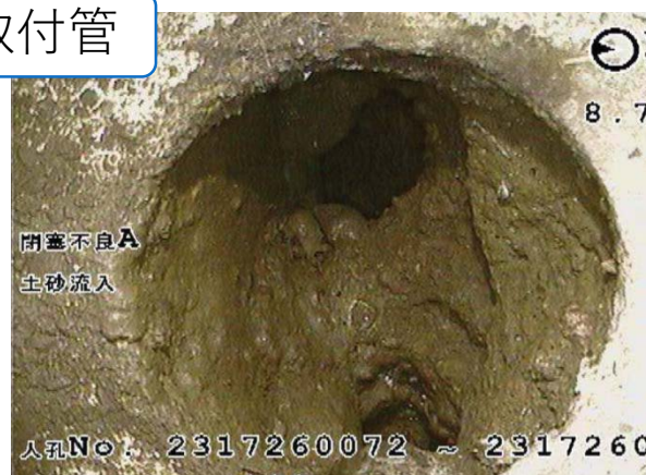
取付管異常（土砂流入）
