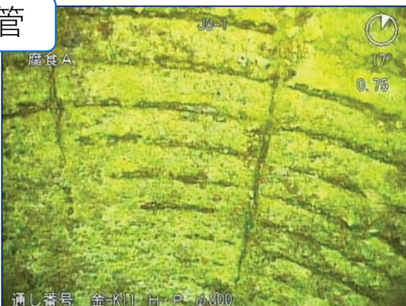
腐食による鉄筋露出
