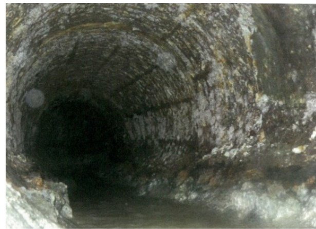
下水道管が腐食し 鉄筋露出した様子
