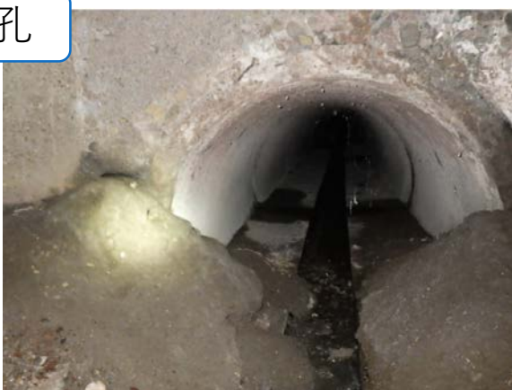
管口の破損・堆積
