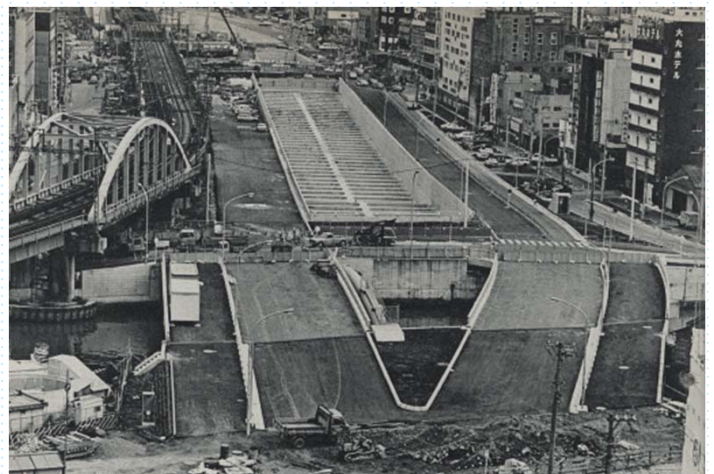
首都高速道路横羽線の建設中、V字型の橋は桜川A橋、桜川B橋、橋下は大岡川
