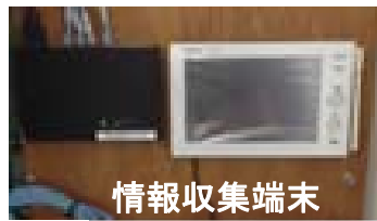
太陽光発電設備（5kW）
