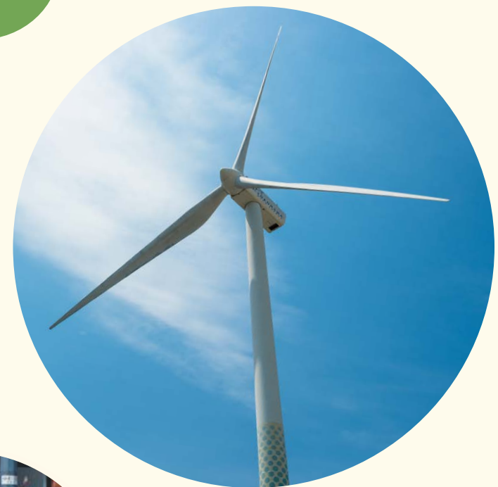
横浜市風力発電所 (ハマウイング)
