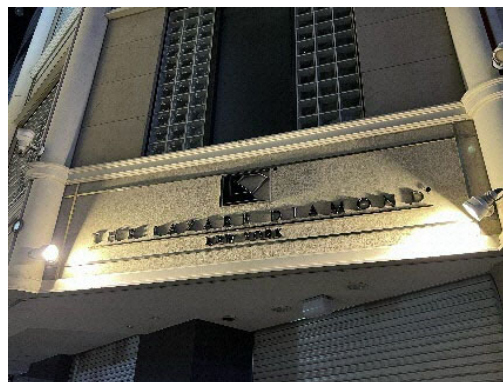
外照式照明装置
